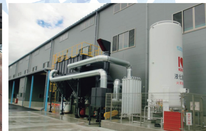
外部に設置した集塵機(ホッパー)
